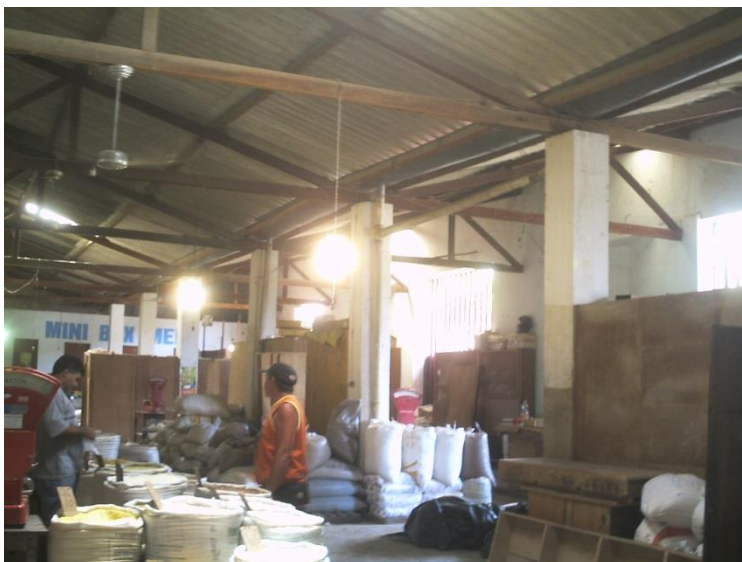
VISTA INTERIOR DO MERCADO, MOSTRANDO A BAIXA ALTURA DA TELHA DE FIBROCIMENTO - FOTO: WILTON MACEDO
