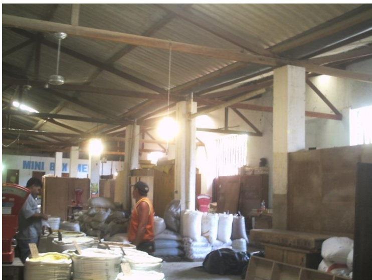
VISTA INTERIOR DO MERCADO, MOSTRANDO A BAIXA ALTURA DA TELHA DE FIBROCIMENTO - FOTO: WILTON MACEDO
